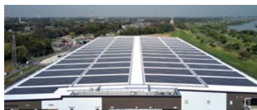
屋根に8,200枚の太陽光パネルを設置
